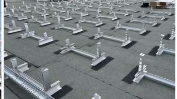
Plots support des panneaux photovoltaïques
