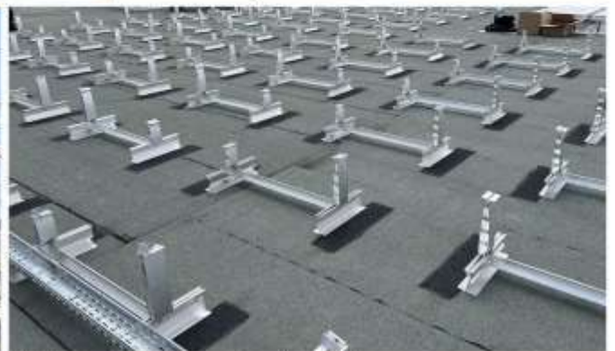
Plots support des panneaux photovoltaïques
